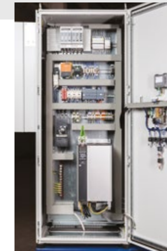
Schaltschrank mit Frequenzumrichter
