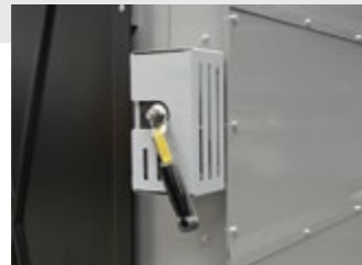
Argano per lo spostamento della piattaforma di manutenzione
