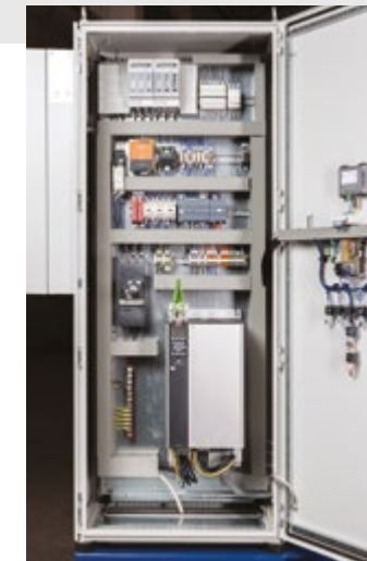
Armário de distribuição com inversor de frequência
